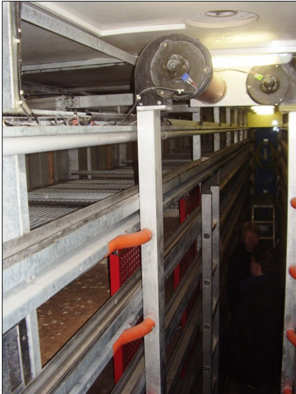
e. Centrifugaal ventilatoren halverwege de wagen, via verticaal kanaal en oranje slangen naar horizontale PVC-buizen (Ø 32 mm) met per mandplaats vijf gaatjes (Ø 7 mm)
